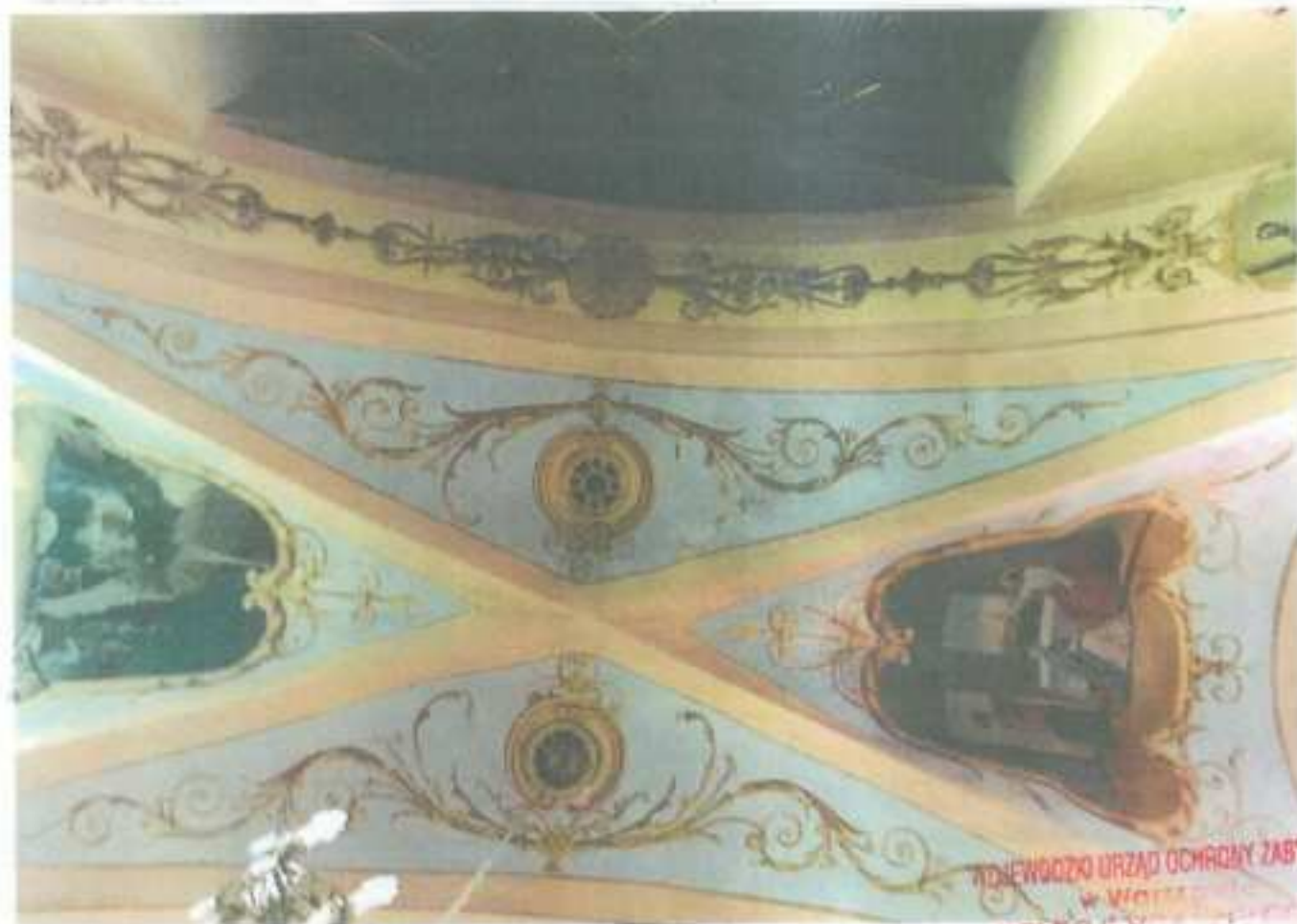
Fot. nr 22 Wyszogród. Kościół p.w. św. Trójcy. Fragment sklepienia na styku ze ścianą wschodnią. Stan przed konserwacją
