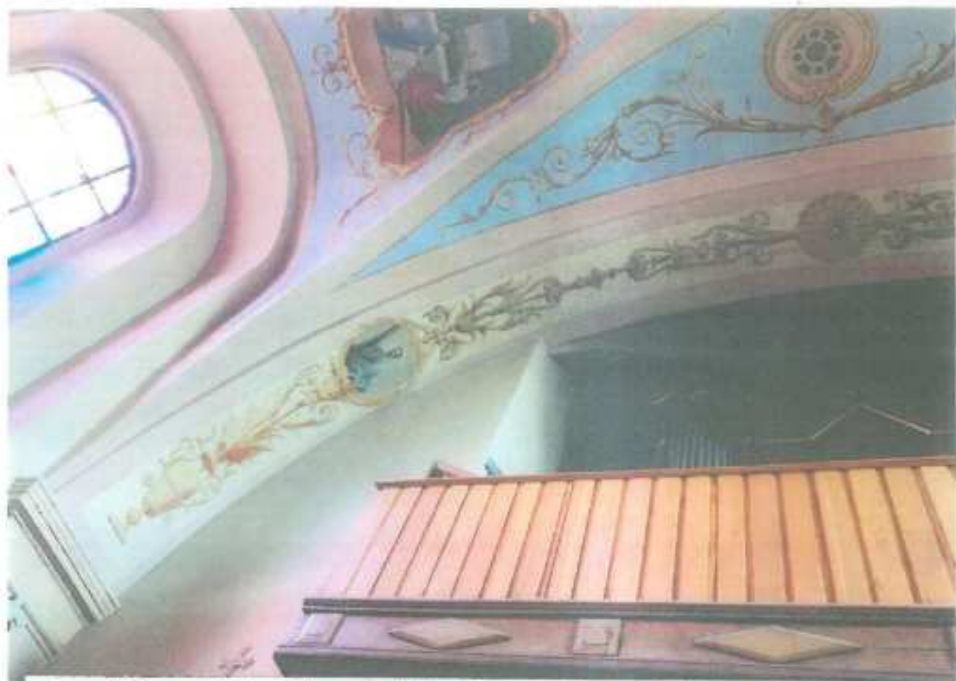
Fot. nr 21 Wyszogród. Kościół p.w. św. Trójcy. Fragment ściany wschodniej i sklepienia. Stan przed konserwacją
