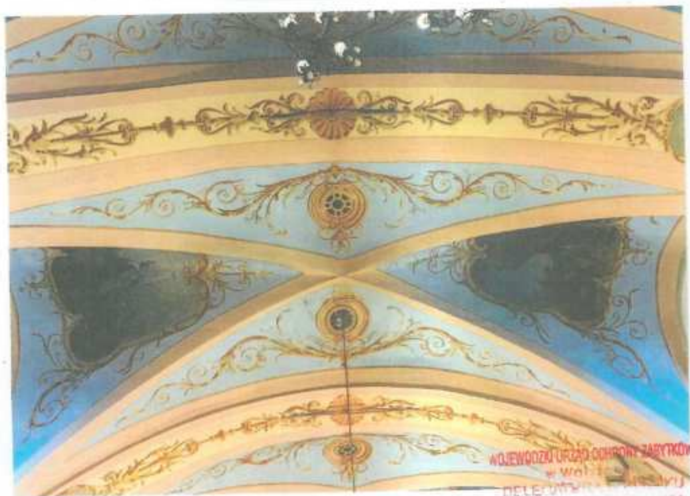
Fot. nr 20 Wyszogród. Kościół p.w. św. Trójcy. Fragment sklepienia. Stan przed konserwacją
